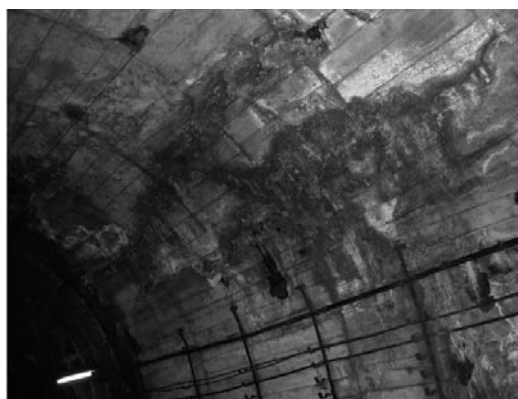
Рис. 9. Образование высолов на монолитной железобетонной обделке, которая заменила разрушенные чугунные тубинги
