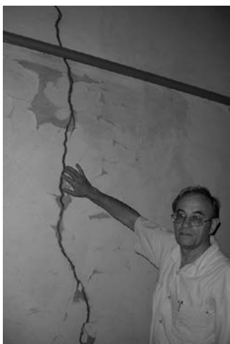
Рис. 1. Дача Ф.И. Шаляпина в г. Кисловодске (общий вид и трещины в стенах)
