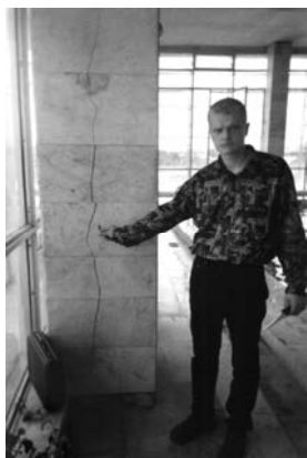
Рис. 3. Плавательный бассейн в г. Минеральные Воды (общий вид и трещины в колоннах)
