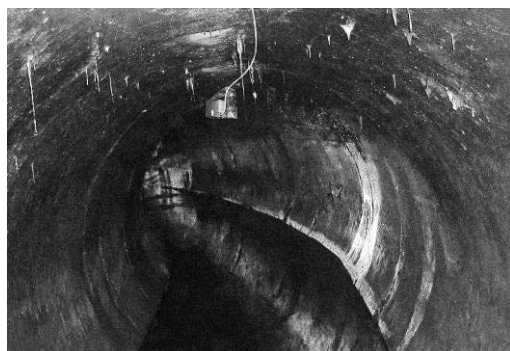
Рис 9. Вибродатчик СМ-3КВ, установленный в своде коллектора
