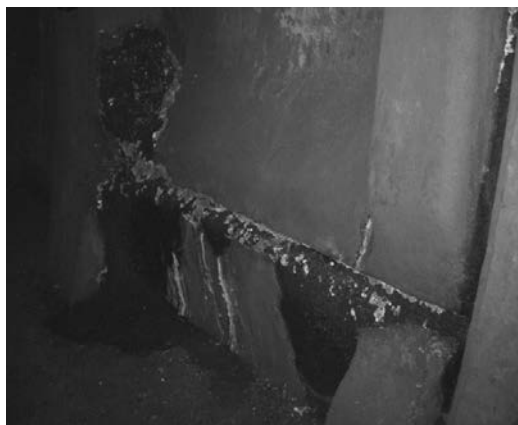
Рис. 5. Течи из стыков между блоками обделки с образованием высолов
